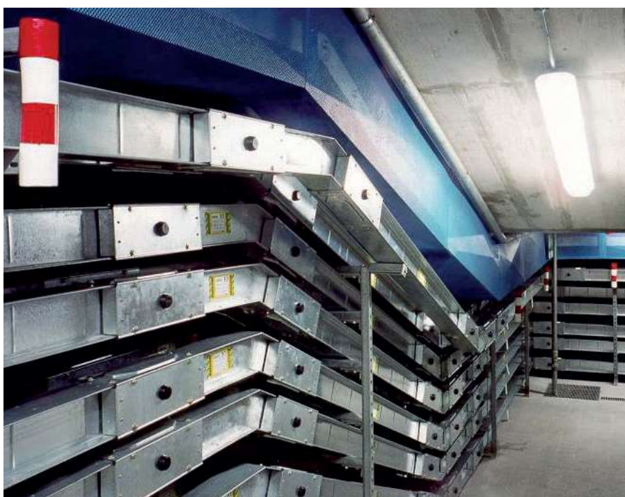
Ejemplo de distribución de alta potencia
